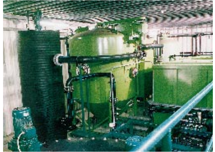
Abb. 13: Die Sedimentationsbehälter und Reinwasserbehälter im Vordergrund, im Hintergrund der Kiesfilter
