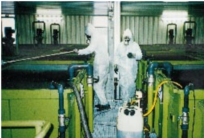
Abb. 5: Überblick über die Altanlage (Deponiewasserreinigungsanlage)
