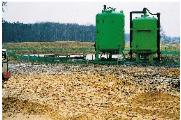
Abb. 23: Die Filtrationsanlage am Auffangbecken
