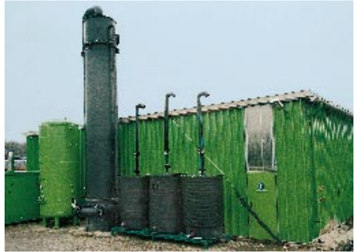
Abb. 11: Die Strippanlage incl. Aktivkohleabluftfilter
