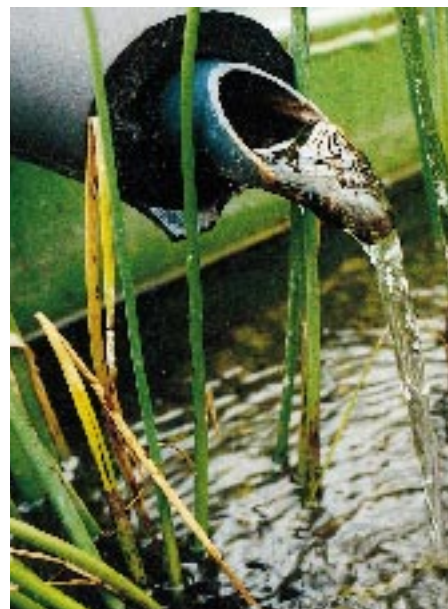
Abb. 7: Auslaufwasser der Pflanzenkläranlage
