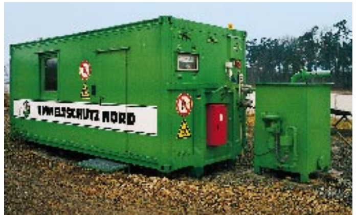
Abb. 20: Übersicht der Deponiegasbehandlungscontainer, im Vordergrund der Biofilter
