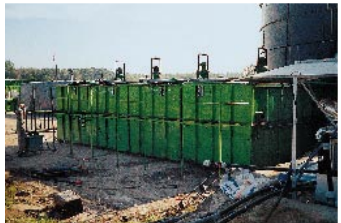
Abb. 15: Die provisorische Anlage in der Nähe der Hochbehälter
