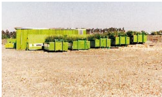
Abb. 8: Die Pflanzenkläranlage, im Hintergrund die Deponie- wasserreinigungsanlage
