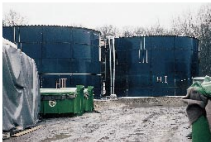
Abb. 4: Hochbehälter zur Lagerung von Deponiewasser
